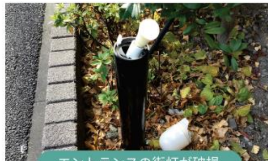
エントランスの街灯が破損
