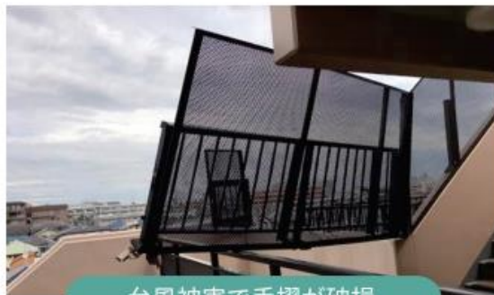
台風被害で手摺が破損
